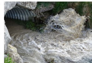
Richigenbach (RIH001), Rohrbruch verursacht Trübung.
