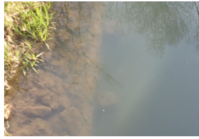
Hauptkanal (HKA001), trübes Wasser, Verschlammung.
