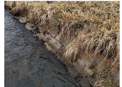
Abbildung 10: vollständig verbaute Rinne im Kontrollabschnitt
